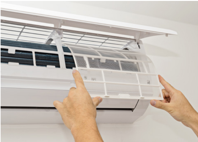
تنظيف فلاتر الهواء للوحدة الداخلية للمكيف
